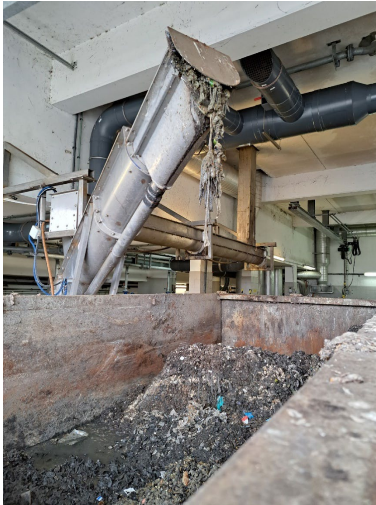
Figure 9 : Refus de dégrillage à l'entrée d'une station d'épuration (©Cedre)
