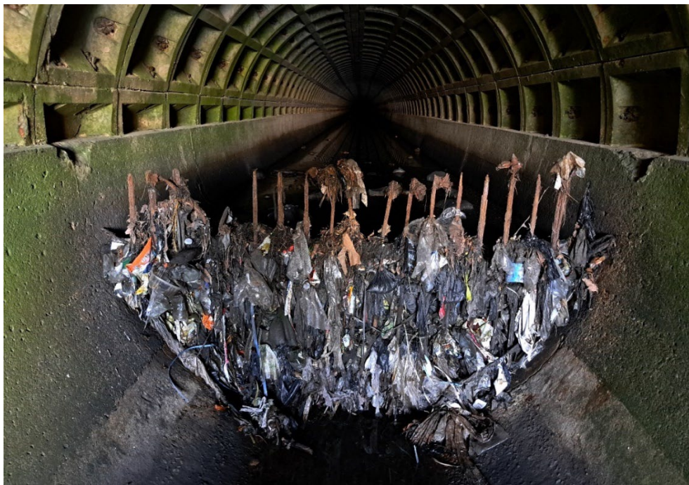
Figure 6 : Dégrilleur installé en sorti d'un déversoir d'orage présentant de nombreux macrodéchets enchevêtrés (©Cedre)
